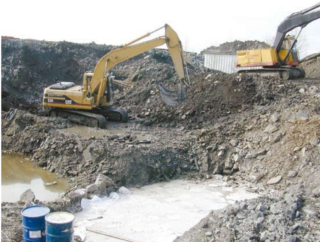
Utgraving og opprydding av en gammel avfallsfylling der Telenor nå har bygget på Fornebu. Fortsatt gjenstår en lokalitet på Fornebu som ikke er oppryddet. (Foto: Statsbygg)
